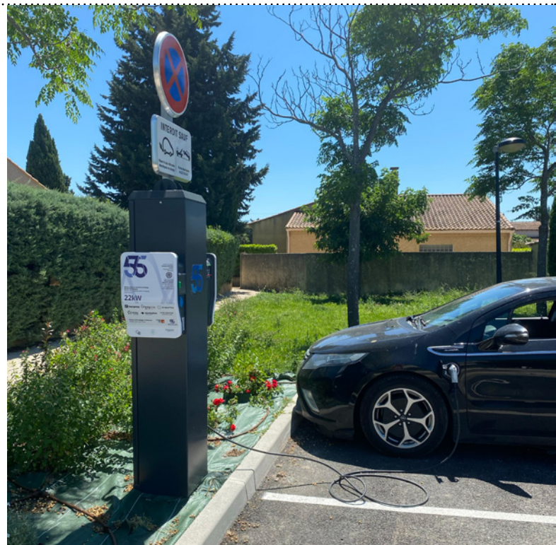
▲ Borne de recharge électrique dans le « Grand Avignon »
